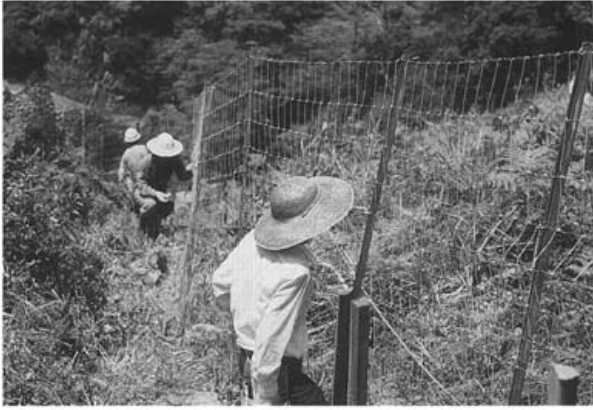
金網フェンスによる防護柵
