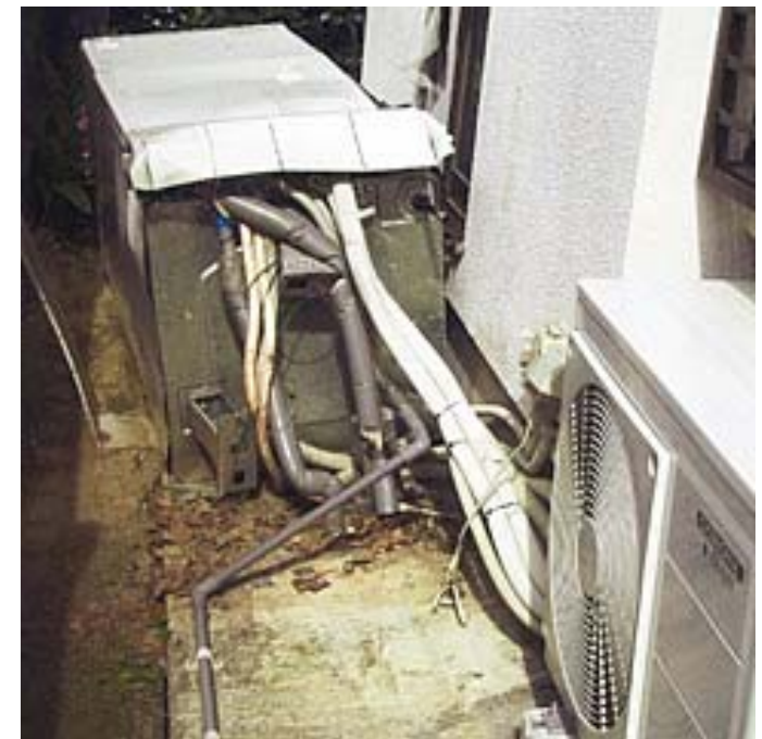
【熊本地震で転倒した電気給湯機】
