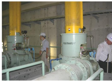
じょうか 浄化センターにある「ポンプ」 おすいかん 汚水管で集まってきた汚水を おすい 地上にある池にくみあげています。
