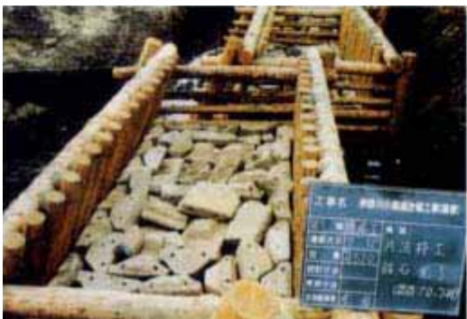
片法砕工の詰石に不要となったブロック材を再利用 (伊野川・島根県)
