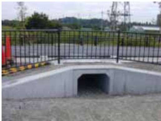
ボックスカルバート（中型哺乳類用）
