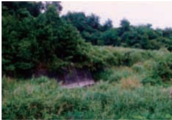
平成7年6月 急勾配のコンクリート護岸が続き、ヨシなどの植物が繁茂し、水辺へのアプローチが困難である。
