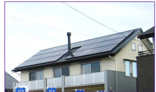
住宅における自然エネルギーの利用事例（太陽光発電）
