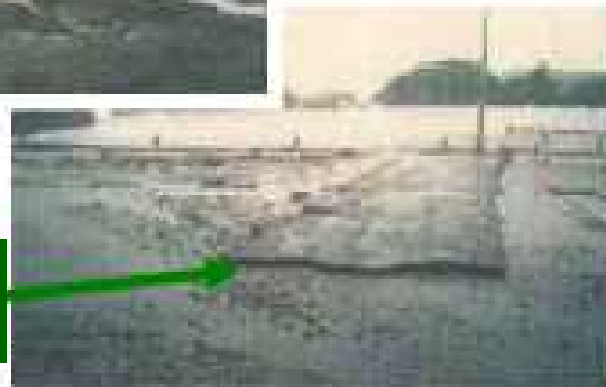
波によって破壊された 岸壁コンクリート
