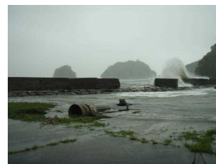
台風で損壊した防波堤 (穴喰漁港)
