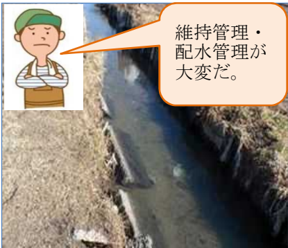
老朽化した用水路
