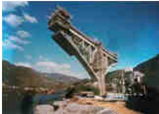
上部工の施工状況 (西日本高速道路株式会社四国支社提供)
