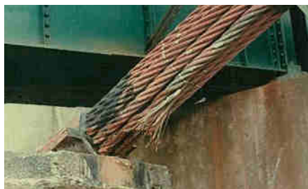
写真-14 三好橋のメインケーブルの破損(大岩義雄氏提供)
