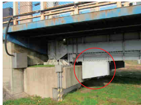
写真-32 大規模な地震により落橋しないための対策
