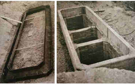
写真-17 井筒杓(左)と沈下完了した井筒(右) (阿波中央橋架設工事報告書)
