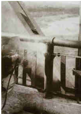
写真-29 現場溶接による高欄の格子部材の接合 (阿波中央橋架設工事報告書)
