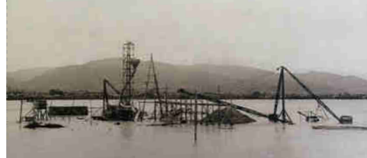
写真-4 ジーン台風による被害 (昭和25年9月3日) (阿波中央橋架設工事報告書)
