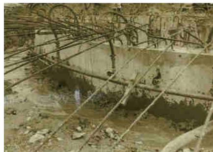
写真-25 井筒の沈下状況(名田橋工事報告)
