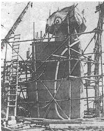
写真-11 ケーソン周壁コンクリートの継ぎ足し状況 (公益社団法人 土木学会附属土木図書館所蔵)
