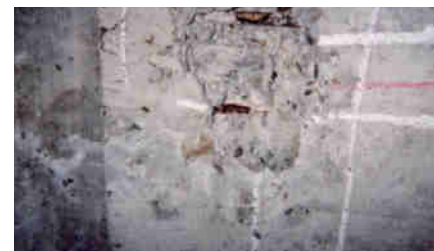
写真-24 中性化によるコンクリートの損傷 (吉野川橋以外)
