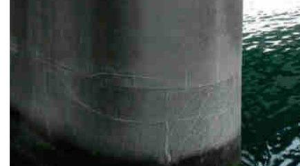
写真-23 塩害によるコンクリートの損傷 (吉野川橋以外)
