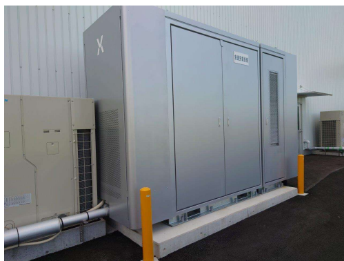
蓄電池ユニット
