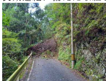
斜面崩壊による道路の通行止
