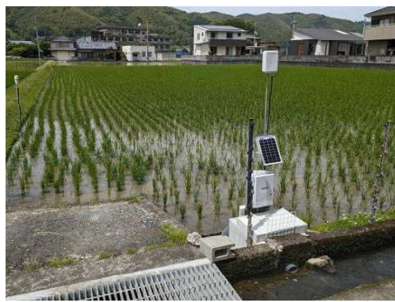
遠隔操作型給水ゲート
