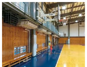
県立学校体育館の空調設備
