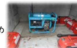
自家発電装置
