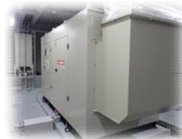
自家発電設備
