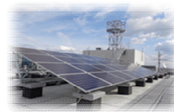
太陽光パネル
