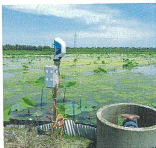
水位センサーの 設置状況
