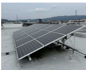
太陽光パネル設置施設
