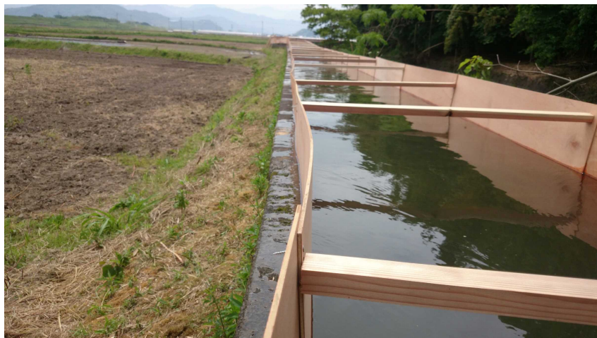
図4－6 合板で応急処置を行った水路
