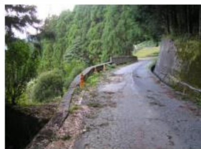
Cブロック 道路の沈下
