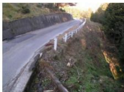
Aブロック 道路の沈下
