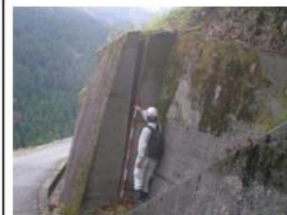
Cブロック 道路擁壁の開き
