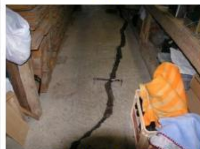
Bブロック 土間コンクリートの地割れ
