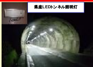
高品質なLED照明の活用(県道 鳴門公園線)
