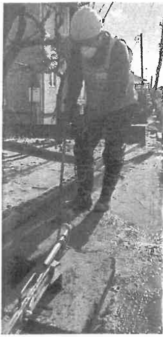
新潟市の住宅地で液状化で噴き出した砂で埋まった側溝の清掃作業
