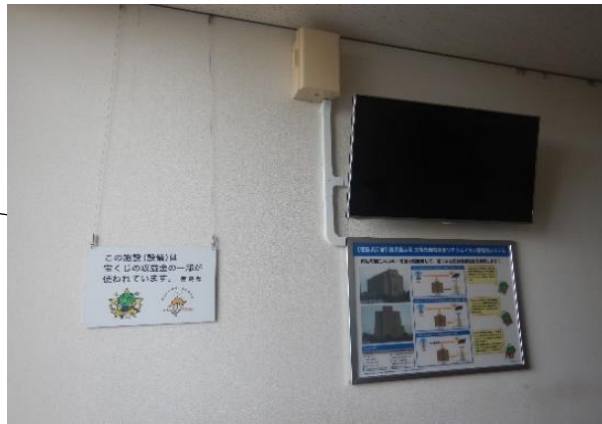
モニター・蓄電池システム （展望者ロビー）
