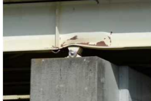
【支承損傷による桁の変形】
