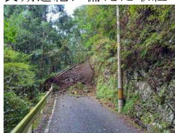
斜面崩壊による道路の通行止
