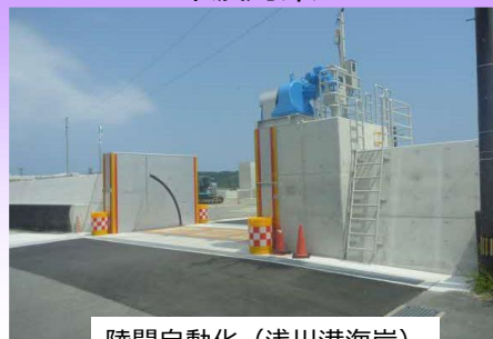
陸閘自動化 (浅川港海岸)
