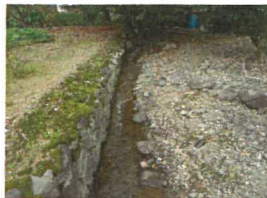
調査計画策定(農地への溢水状況)
