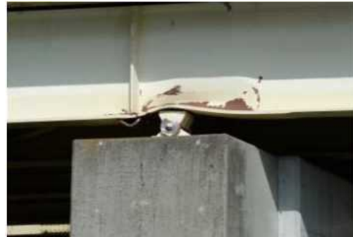
【支承損傷による桁の変形】
