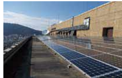
県庁の太陽光発電設備
