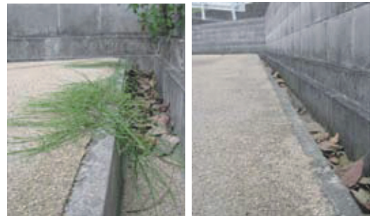
ハシピタン未施工
