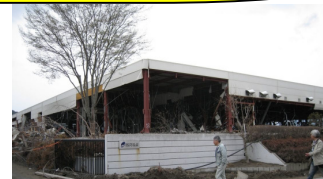
電子部品工場崩壊によるサプライチェーンの寸断
