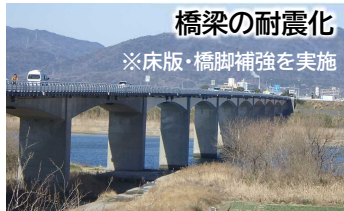
橋梁の耐震化 ※床版・橋脚補強を実施 徳島引田線 名田橋 (藍住町)
