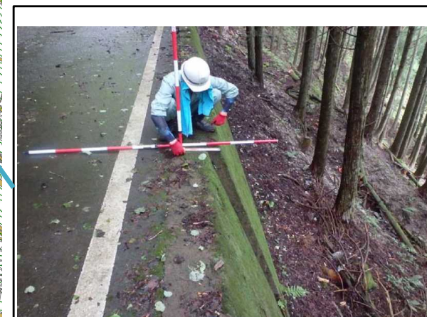
道路擁壁の押し出し
