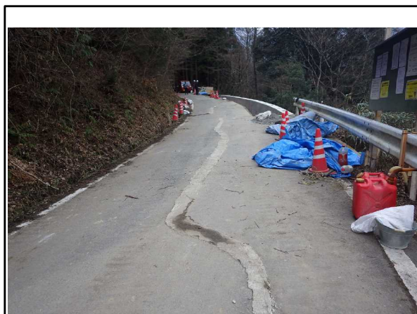
市道路面クラック
