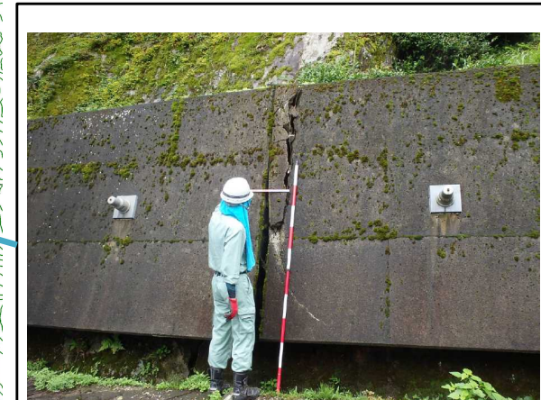
コンクリート受圧版の変状
