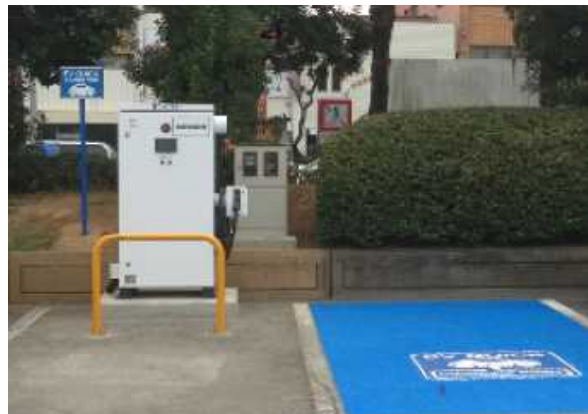
急速充電器設置箇所
