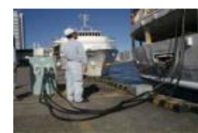
係留船舶への 陸上電力供給
