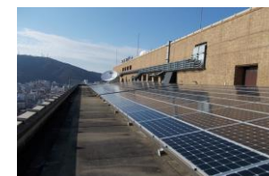
県庁屋上の太陽光発電設備
