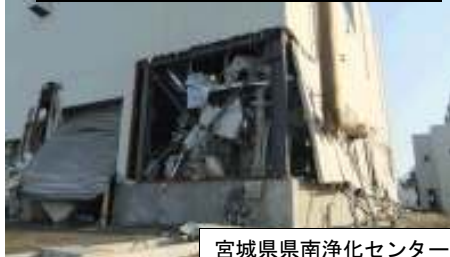
宮城県南浄化センター
