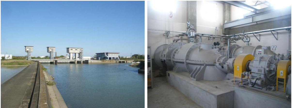
出島川排水機場
