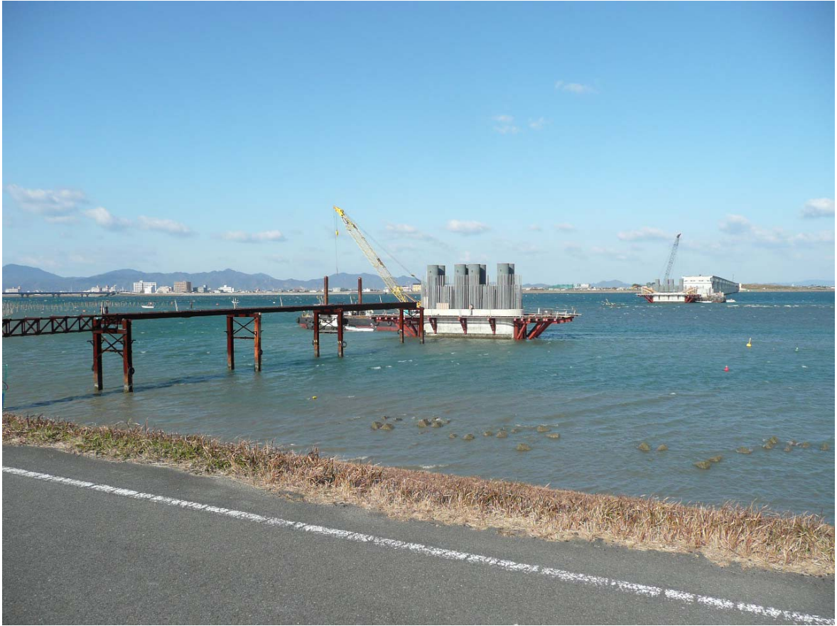
写真2 足場設置工,配管架台設置作業状況(干潟部:P2) (平成22年1月6日)
