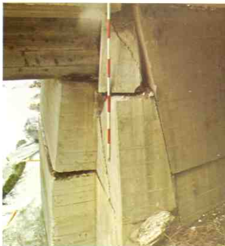
美馬郡一宇村林道九藤中線 土石流により破壊さ れた橋台。
