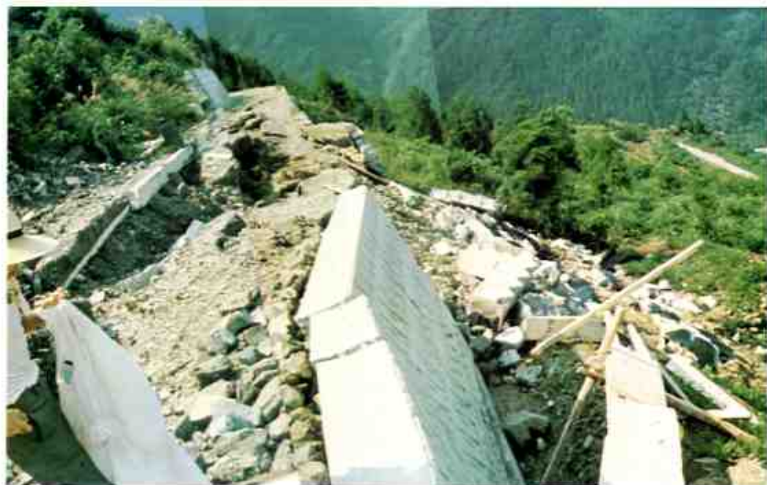
林道程原線 地すべりによる林道の欠壊。
