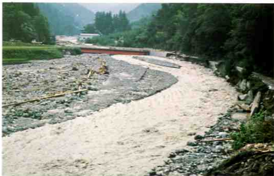
美馬郡木屋平村林道猪の谷線（猪谷橋） 土石流により支保が30cm移動した。
