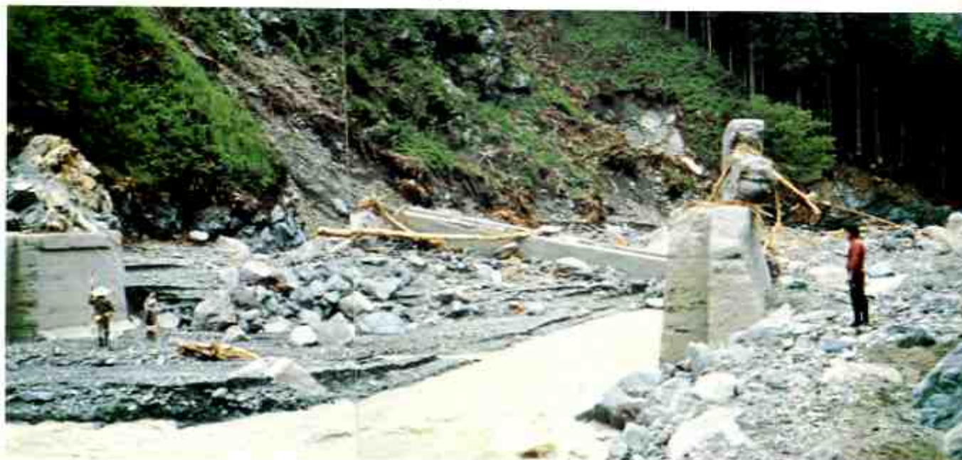
林道槍戸線飛石橋(RCT21m)の流失
