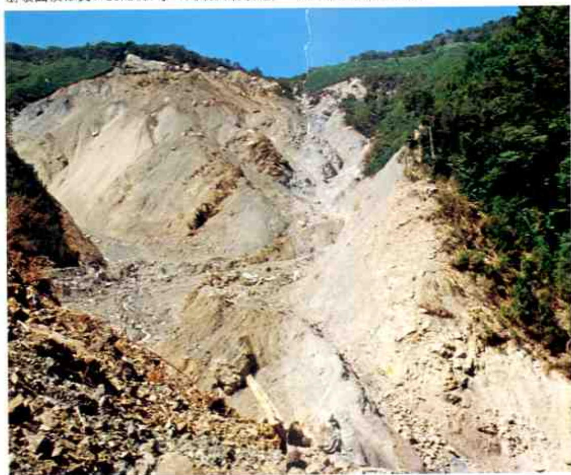
崩壊面積は実に23ha(17号の内最大崩壊地) 吾賀郡木頭村久井谷
