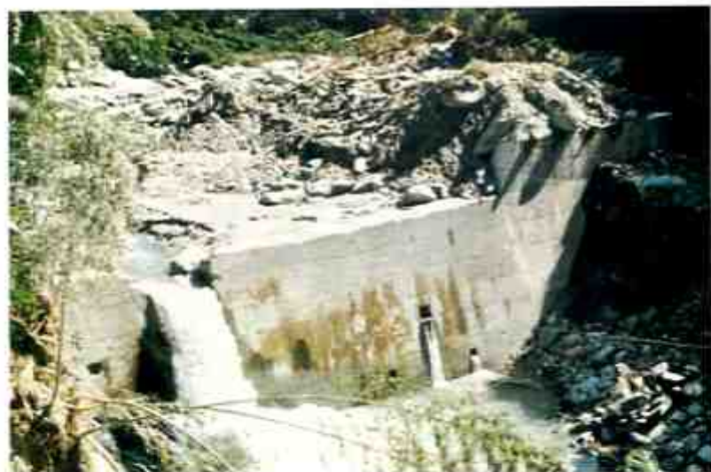
土石流は治山谷止工を越流しており土石流のもの凄さを物語っている。美馬郡穴吹町古宮宇田ノ内地区
