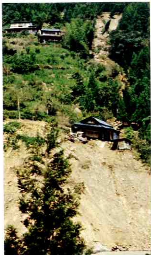
溪岸浸蝕の崩壊により 人家破壊
