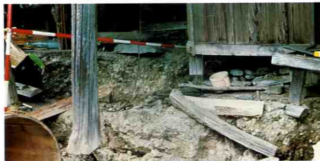
地すべりにより約1 mの落差を生じた 穴吹町内田Bブロック地内
