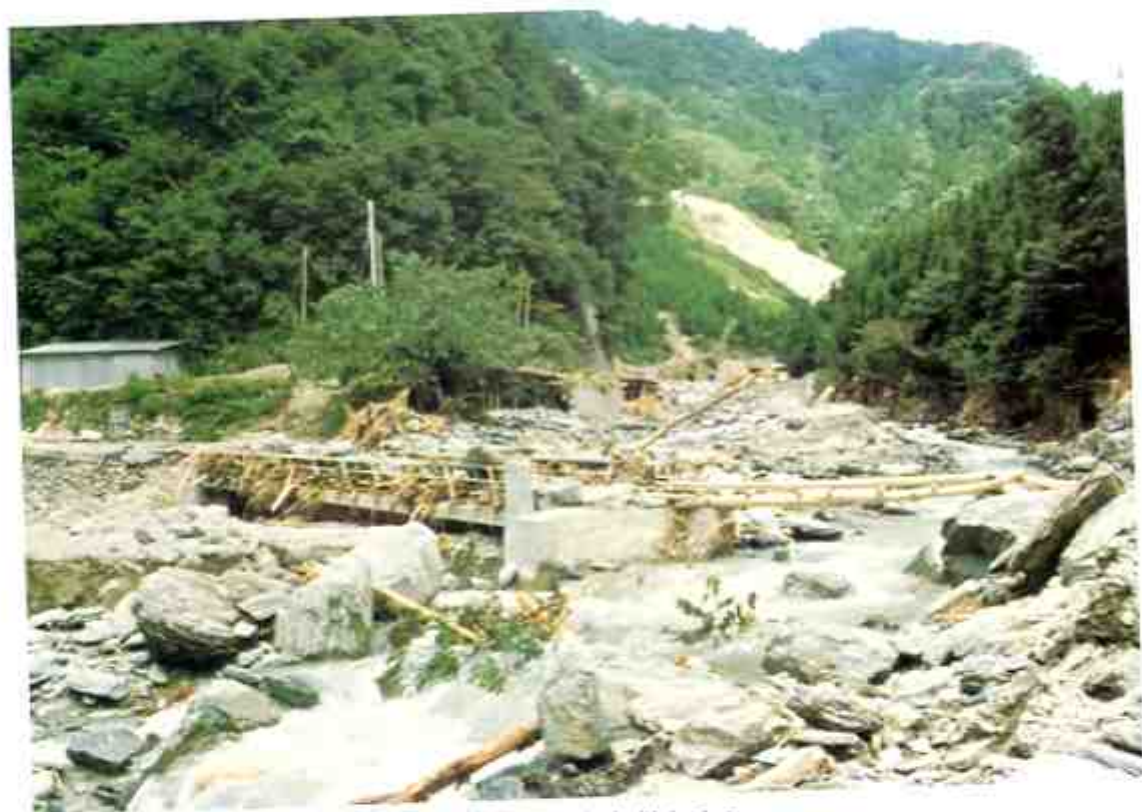
土石流により葛生橋被害 筑馬郡穴吹町古宮字葛生地内
