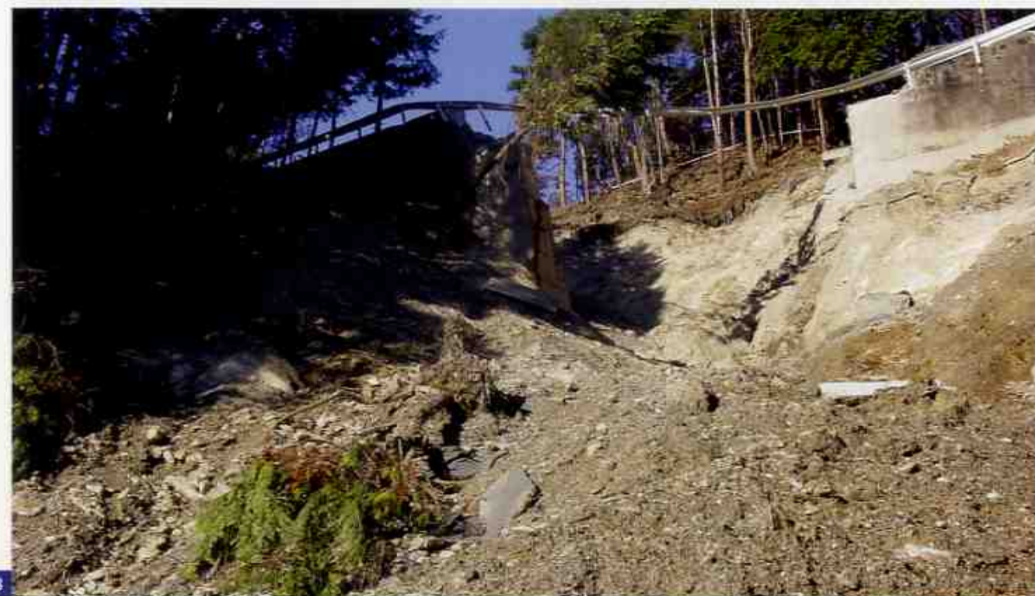
▲【美馬市穴吹 林道杖立線の被災状況】
