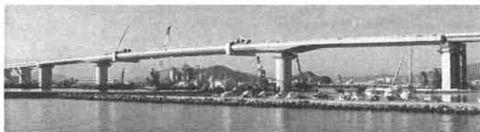
新町川橋(令和2年12月5日撮影) 新町川橋500mの最後の中央橋脚(250m)が令和2年12月5日に国内最大のクレーン船海翔により設置され、徳島沖洲IC～徳島津田IC(県が整備する地域活性化IC)2.4kmが令和3年3月21日に開通しました。
