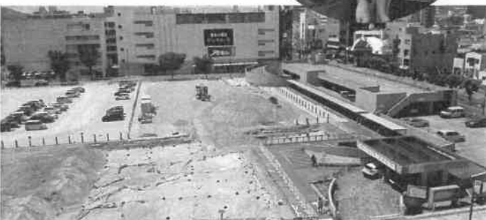
▲香川県丸亀市丸亀文化美術会館建設予定地視察(2022年8月16日)
