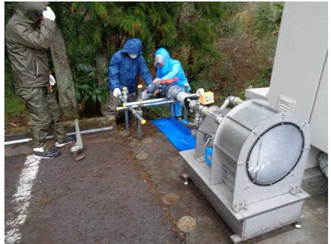
図-34 ペルトン式水車の設置状況
