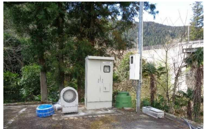
図-36 ピコ水力発電機全体
