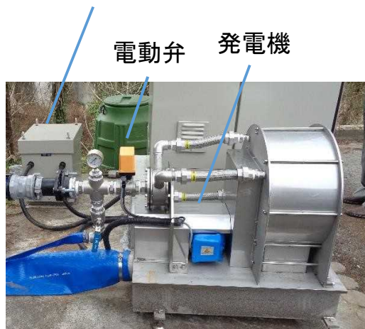
図-43 発電装置と直流分流防止変圧器
