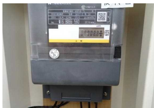
図-44 スマートメーター
