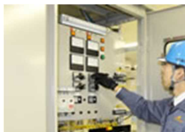
図-48 電気機器の点検 20)
