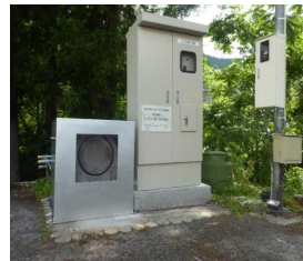
装置全景(防音ボックス有り)
