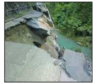
唯一の生活道路が崩壊(国道)
